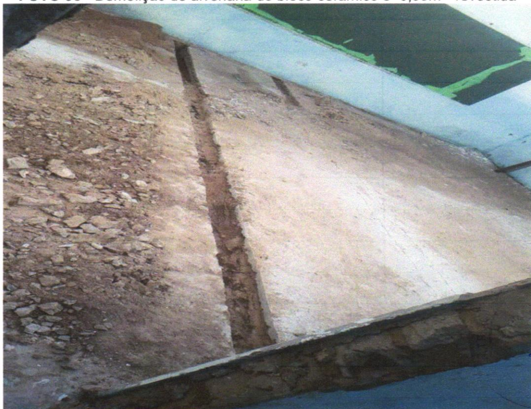
FOTO 04 – ESCAVAÇÃO MANUAL DE VALA PARA VIGA BALDRAME (INCLUINDO ESCAVAÇÃO PARA COLOCAÇÃO DE FÔRMAS). AF_06/2017
